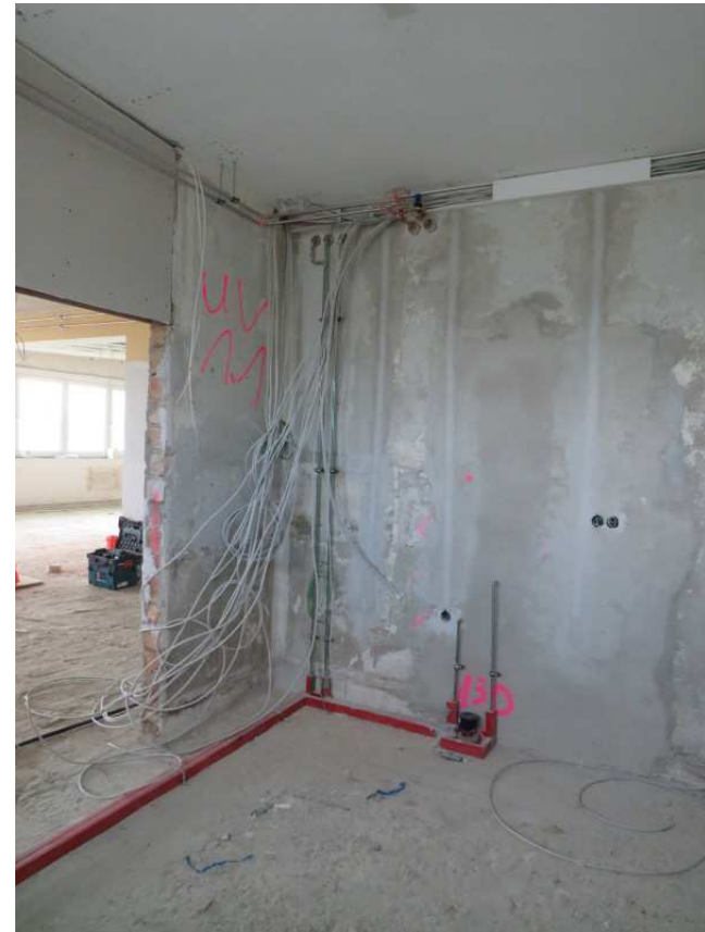
Küche mit neuen Leitungen
